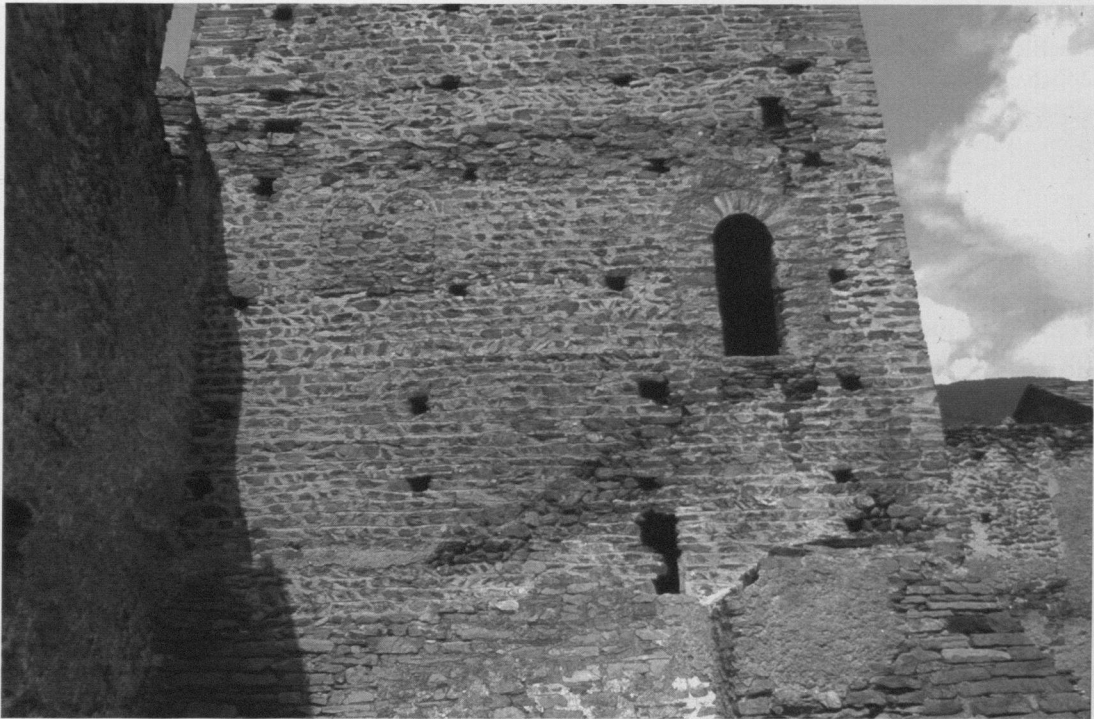
Fig. 4 : Ruine Cly, unterer Teil des Bergfrieds von Süden, mit Einstieg und zugesetzter Biforie eines Hauses oder Wohnturmes (dendrochronologisch 1027), der nachträglich zum Bergfried umgebaut wurde.
