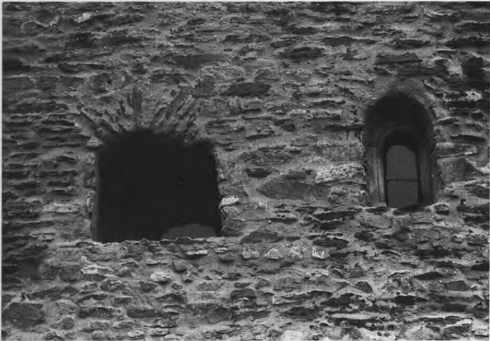
13. Niederburg Rüdesheim, Einfachfenster zum Treppenhaus und Doppelfenster der Phase 2 im 1. Obergeschoß, Westseite.
