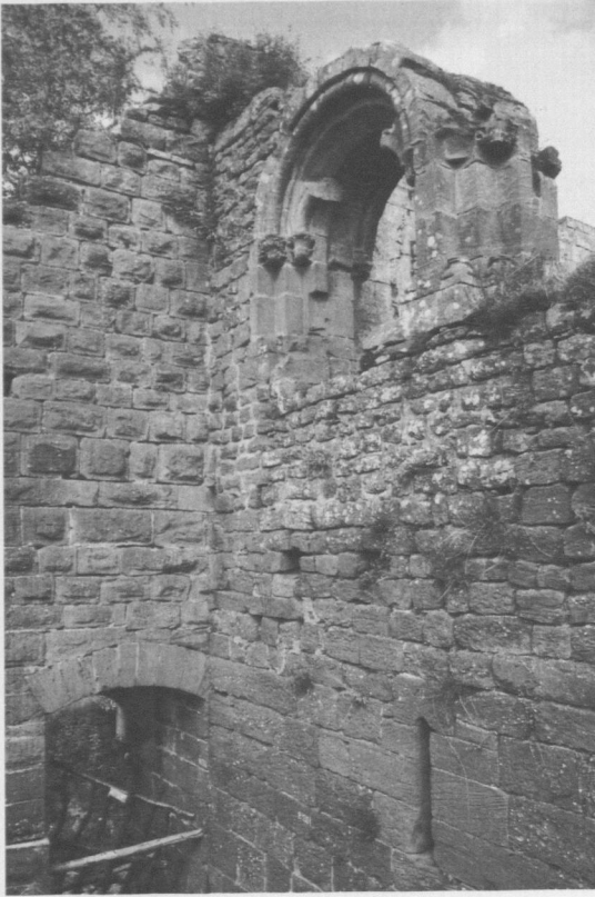
8. Girsbaden. Die Südwand des Saalbaues außen, mit dem teilweise erhaltenen Fenster des Saales; links unten das Tor, zu dem die Brücke von der Vorburg führte
