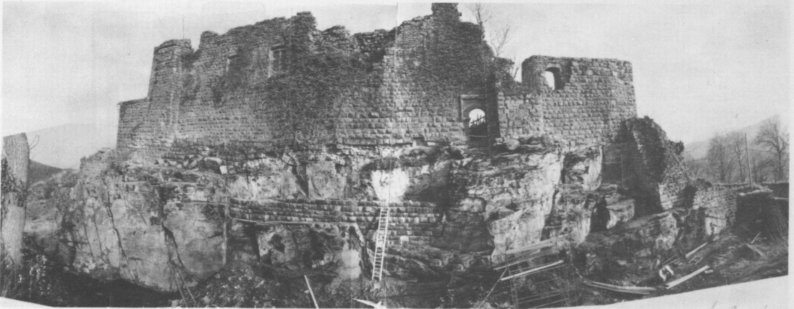
6. Girbaden, Westansicht des Saalbaues bzw. der Westseite der Kernburg über dem Graben, 1971; die Gewändereste des Saales im Obergeschoß waren damals erkennbar
