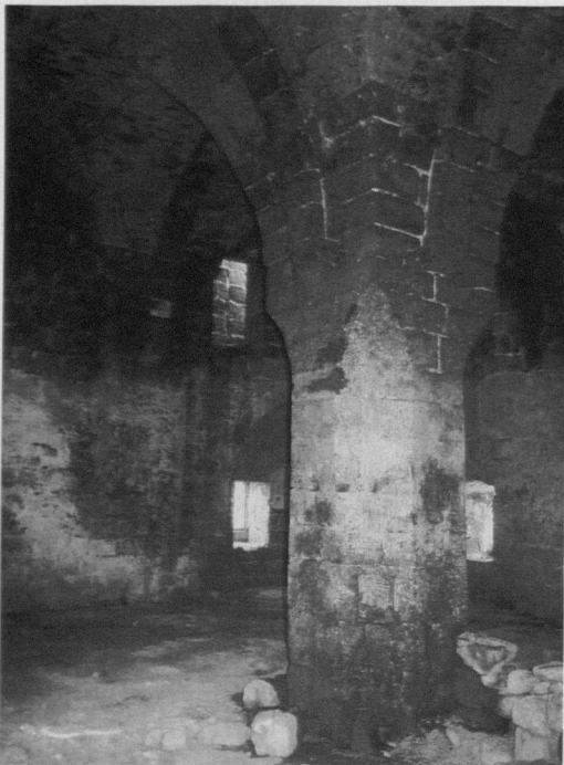
c) 1. und 2. Obergeschoß des Wohnturmes gegen Nordosten. Die Lage der zerstörten Balkendecke ist an den Wänden durch die helle Tünche unten und den Ruß oben markiert. Im 2. Obergeschoß ist die Pforte der Wandtreppe sichtbar (2000).
