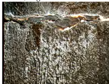
Abb. 7.1 / 6 (B_II_01) Hintergrundfläche Innentafel; Fuge zwischen Brett I und II
