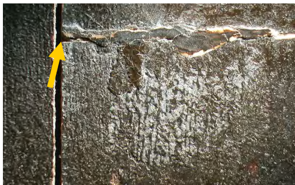
Abb. 4.2.1 / 5 (B_II_01) Linkes Ende der Fuge zwischen Brett I und Brett II
