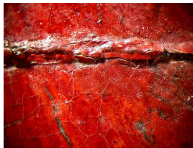
Abb. 7.1 / 3 (B_III_06) Mieder, Fuge zw. Brett III/1 u. /2
