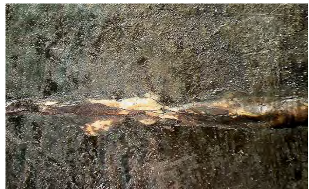
Abb. 4.2.1 / 6 (B_III_04) Ärmel links, Fuge zwischen Brett III/1 und /2
