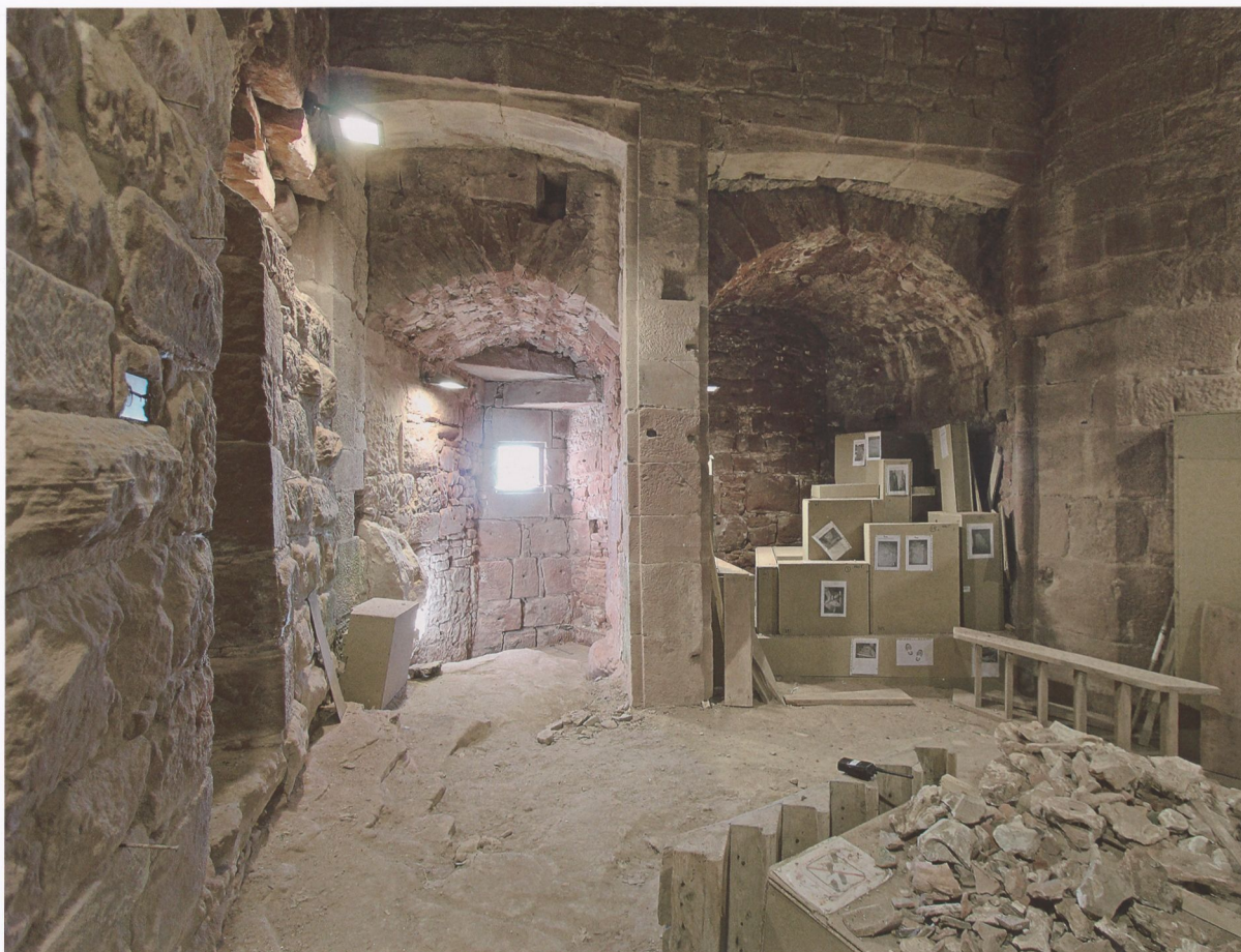
Abb. 11 Hohkönigsburg, „Großes Bollwerk“, Erdgeschoss des Südturnes, Ostwand von innen. Die (im Foto verdeckte) Geschützscharte rechts und das kleine quadratische Fenster links wurden infolge einer Planänderung in die Nischen eines Tores (rechts) und einer Fußgängerpforte eingebaut, von denen nur die Werksteine der inneren Nischenkante erhalten sind.
