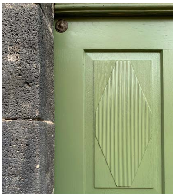
Abb. 6 Haustür von 1840 mit Leinölfarbanstrich.
