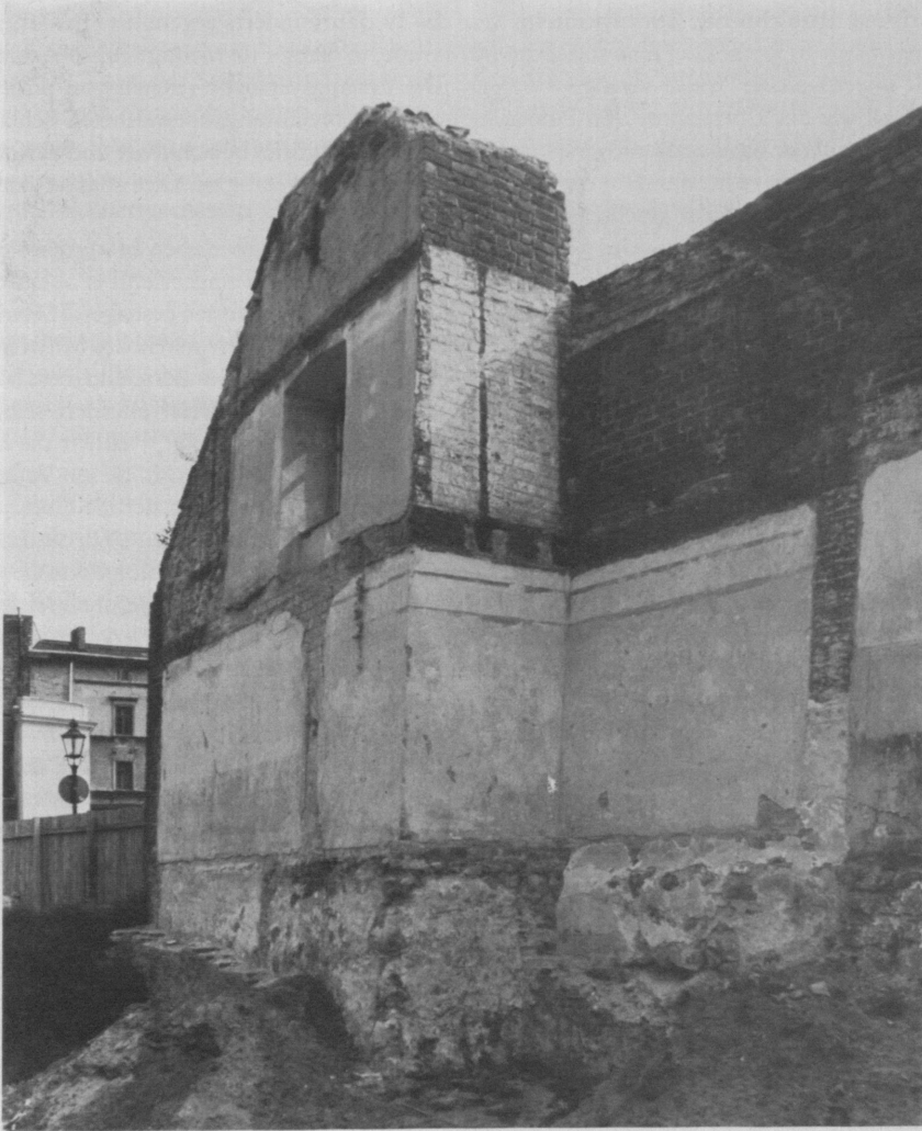
Abb. 1: Zustand von Turm und Stadtmauerrest am Hohen Steinweg im September 1981, Blick von Norden über den alten Stadtgraben (Aufnahme Th. Biller).
