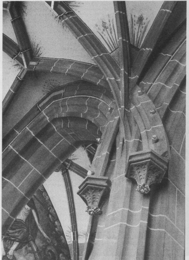
Abb. 11: Wimpfen am Berg, Pfarrkirche, Gewölbeansatz mit »zusammengeschraubten« Rippen in der Nordkapelle (1516 vollendet).
