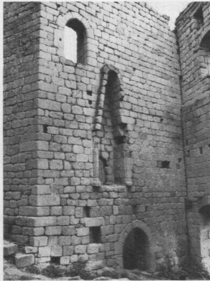
Abb. 17. Spesburg, die Südwand des Ostflügels von Südwesten; die Wand stößt mit durchgehender Fuge gegen die Außenwand. Der Kamin lag in der „Pfortnerstube“, die früher zweiteilige Öffnung in seiner Rückwand diente wohl der Ofenfeuerung des Nachbarraumes (Th. B. 1971).
