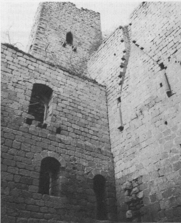
Abb. 13. Spesburg, Nordwestecke des Ostflügels mit dem Bergfried; die Westmauer (links) setzt mit durchgehender Fuge gegen die Schildmauer (Th. B. 1971).
