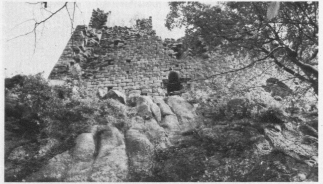
Abb. 10. Spesburg, Nordwestecke von Westen; der obere Teil der Westwand des Bergfrieds ist zerstört, man kann aber links erkennen, wie sie mit Fuge gegen die Nordwand (= Schildmauer) gesetzt ist (Th. B. 1971).
