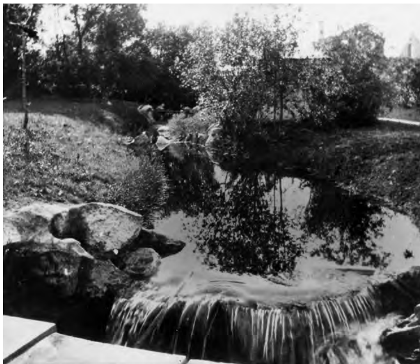
20. Landwarów, budowa kaskady w parku „Szwajcaria”. Fot. przed 1900, Biblioteka Narodowa w Warszawie, Zbiór Rękopisów, Z. Potocka, Teki rodzinne. Tyszkiewiczowie, Potoccy, Lubomirscy, Zamoyscy, Warszawa 1973, rkps sygn. akc. 10114
