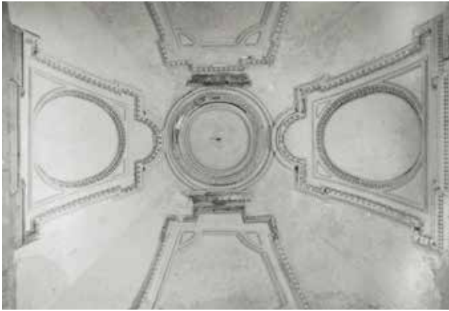
22.7. Gabinet II p., sklepienie, stan przed konserwacją
