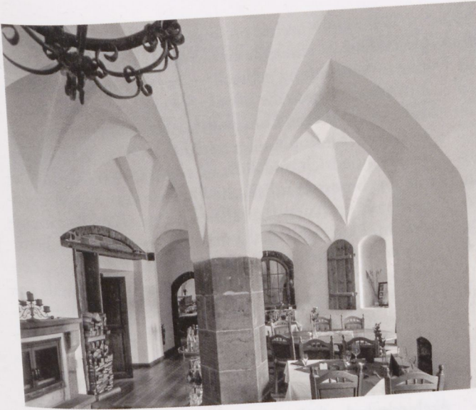
Abb. 32: Würzen, Bischofsschloss, Gratgewölbe im Bereich der Küche im Kernschloss, Klaus Kirchner zugeschrieben, ab 1491
