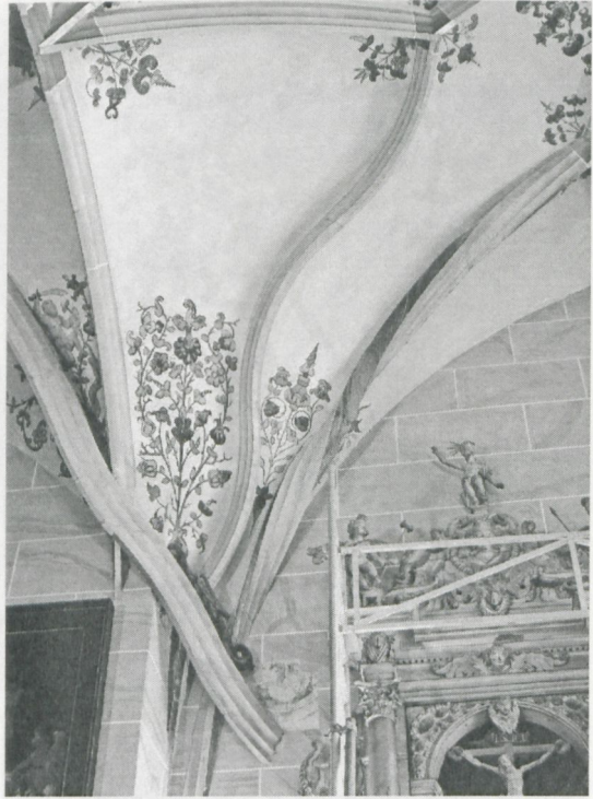
Abb. 14: St. Marien Pirna, Rippenanfänger im Westbereich des Langhauses mit durchlaufender Luftrippe, auf deren Rippenrücken ein Drache emporkriecht
