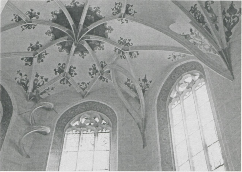
Abb. 12: St. Marien Zwickau, Gewölbe im Südostchor mit bildhaften Rippenanfängern, links: die sogenannte Hobelspanrippe
