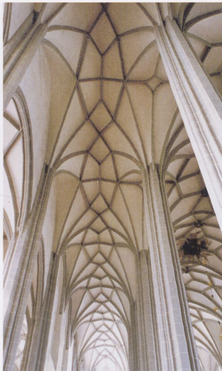
Abb. 31: Görlitz, Peterskirche, Gewölbe des inneren Seitenschiffes
