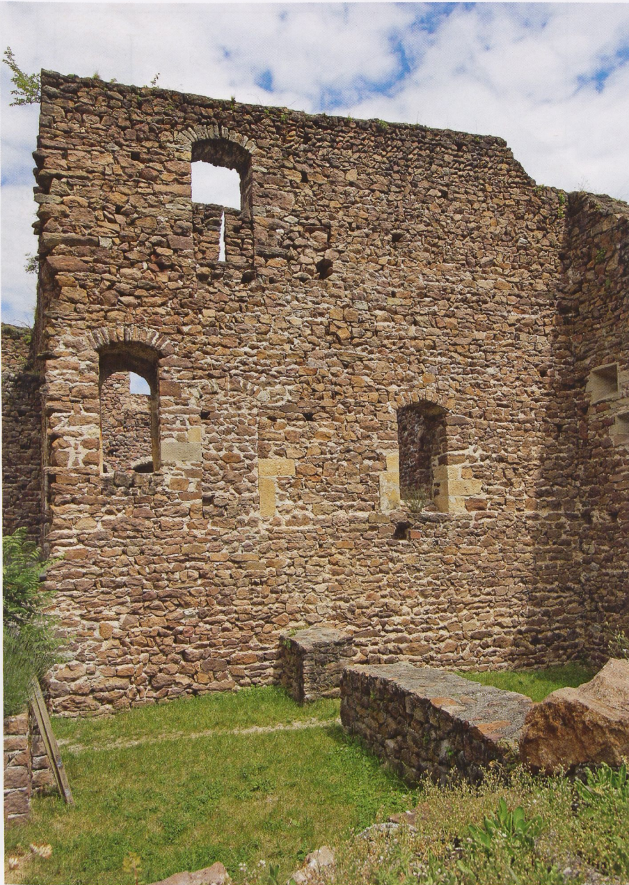
Abb. 28 Boymont, die Westwand des Palas von außen (2014); vgl. Abb. 24. Im 1. Obergeschoss sieht man links die zwei originalen Türen vom Saal im Palas, die linke für einen Treppenlauf höher gesetzt, die rechte vermauert; rechts die sekundäre Tür, die im Saal einen Kamin zerstörte; die Kalksteinquader können Rest einer niedrigen Feuerungsöffnung sein. Im 2. Obergeschoss eine originale Türöffnung, die sekundär zum Lichtschlitz verkleinert wurde.
