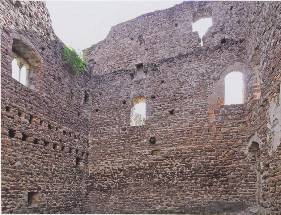
Abb. 24 Boymont, die Westwand des Palas von innen (2009); hinter dieser Wand lag der Westanbau. Unten ist der Holzrest des Unterzugs der oberen Decke bemerkenswert. Darüber sieht man rechts zwei originale Pforten, die linke auf Bodenniveau des 1. Obergeschosses und vermauert, die rechte, offene einen knappen Meter höher gesetzt, was auf einen zugehörigen Treppenlauf deutet. Die Pforte im gleichen Geschoss links zerstörte einen Kamin, dessen Abzug darüber erhalten ist. Die Pforte im 2. Obergeschoss wurde zu einem Lichtschlitz verkleinert (vgl. Abb. 25).
