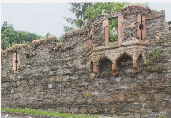
Abb. 9 In Bacharach ist vom Zollhof, der der rheinseitigen Südostecke der Stadtbefestigung vorgelagert war, vor allem ein Teil der Ummauerung erhalten, der nach den Scharfenformen und der Backsteinverwendung aus dem 15. Jh. stammt.
