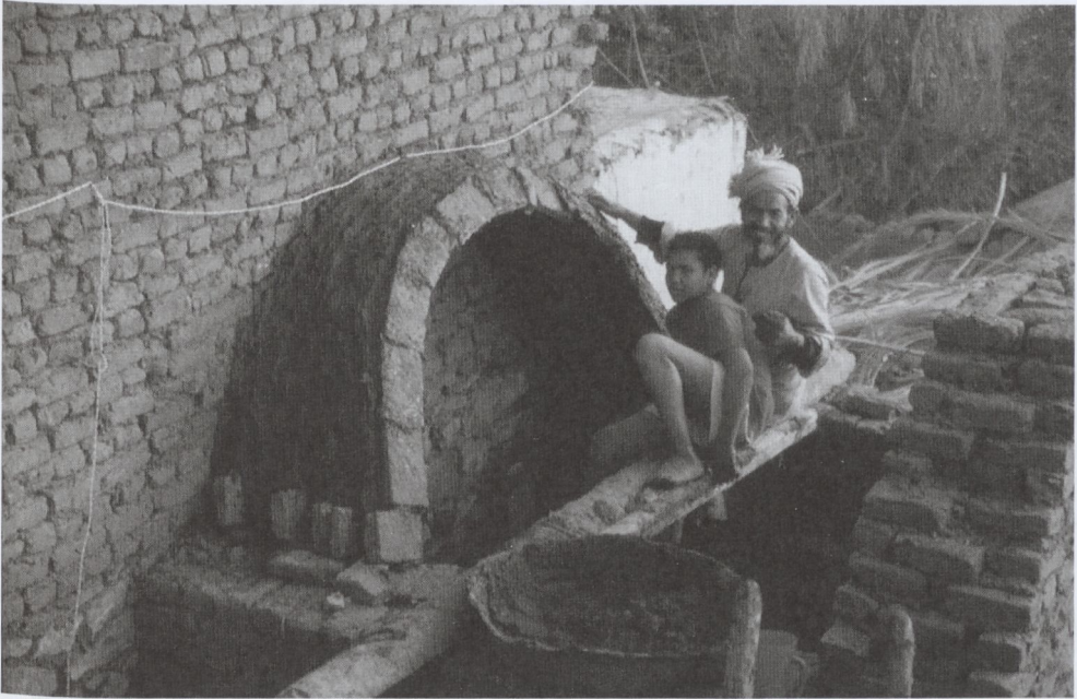
Abb. 1.30: Herstellung eines Kufgewölbes auf Elephantine. Die traditionelle Technik wird auf der Baustelle von Generation zu Generation weitergegeben (Foto: D. Kurapkat 2001).
