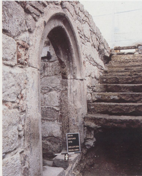
Gotischer Keller aus Sandstein Seestraße 17 Blick in einen Lichtschacht in der Südmauer.
