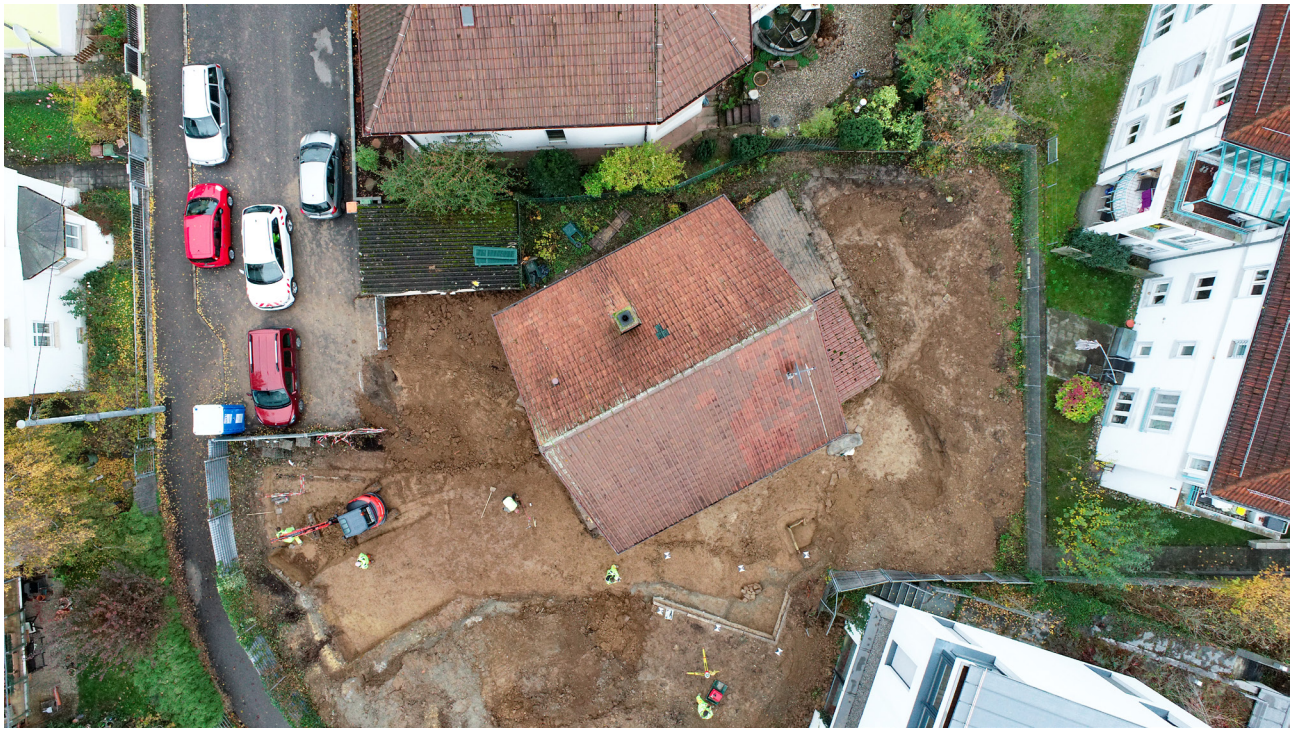
Abbildung 01: Übersichtsbild des Areals. Mittig das Gebäude Burgenlandstraße 115. Norden ist links im Bild.
