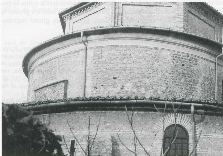
FIG. 6 - Muro esterno della nave mediana e del deambulatorio della Basilica Apostolorum / San Sebastiano (foto E. Jastrzębowska).
