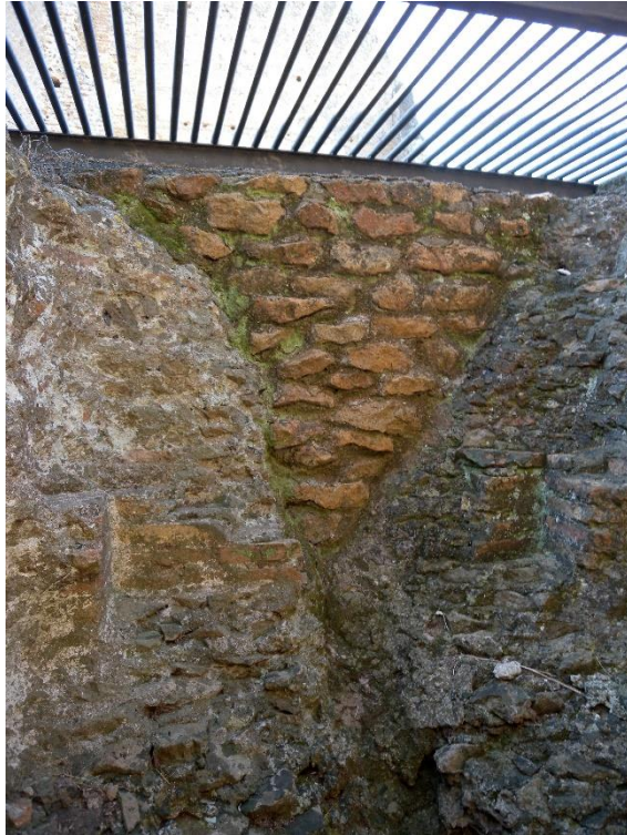
Abb. 46: Tivoli, Villa Hadriana, Winterpalast; drei unterschiedliche Mauertypen im eingebrochenen Bereich von S1 (siehe Abb. 49).
