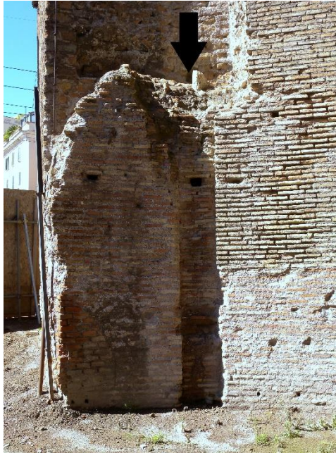
Abb. 43: Rom, Tempio di Minerva Medica; fehlender Teil der Mauer im oberen Bereich des Abzugs in Apsis 4.
