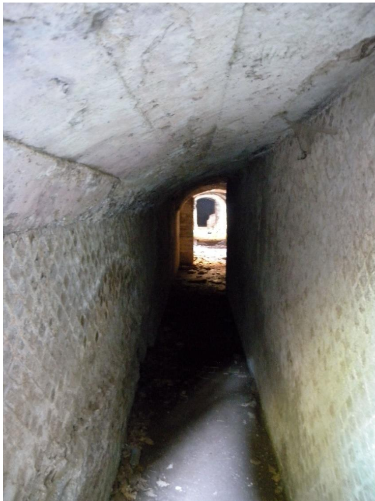
Abb. 71: Tivoli, Villa Hadriana, Winterpalast; rechter Hand die Mauer des nachträglich eingebauten Tonnengewölbes, das den Bedienungsgang auf einer Länge von ca. 9 m verengt (vgl. Abb. 52).
