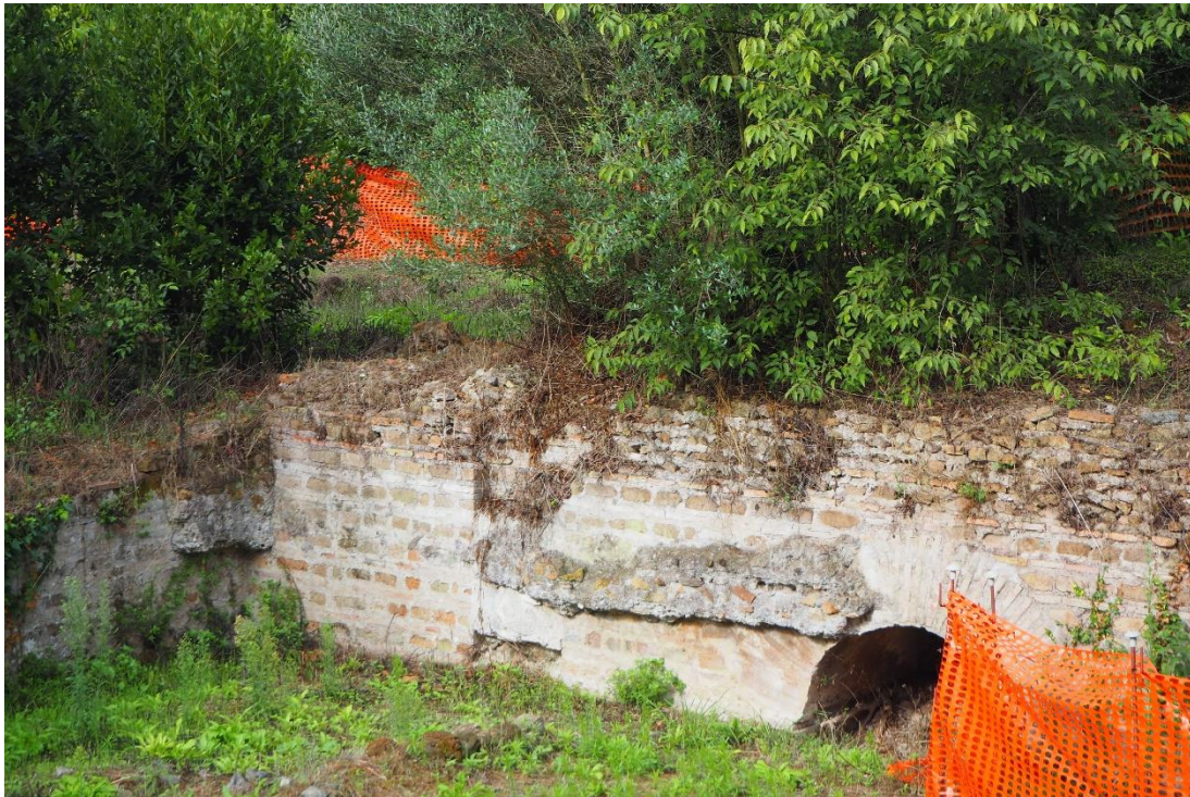
Abb. 21: Rom, Villa des Maxentius, Palastaula: Mörtelreste eines wohl späteren Einbaus.
