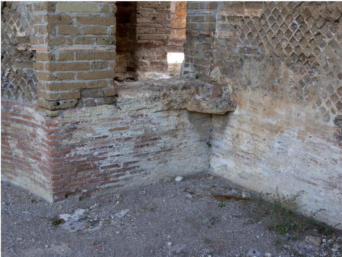
Abb. 50: Tivoli, Villa Hadriana, Winterpalast; kleiner Rest der suspensura in der Ecke von Raum 4 und der deutlich erkennbare Wechsel des Mauerwerks im Übergangsbereich vom Hypokaust zum Raum.
