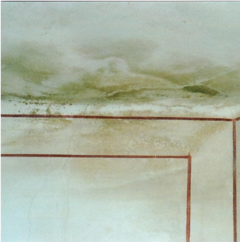
Abb. 60: Archäologischer Park Carnuntum (A), Haus II; zum besseren Verständnis – Versottung im Bereich eines Abzugs.
