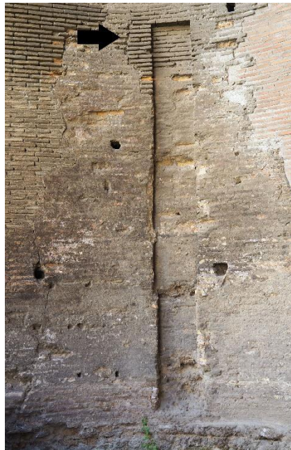
Abb. 42: Rom, Tempio di Minerva Medica; renovierte / restaurierte Stellen am oberen Ende eines Abzugs (A1) in Apsis 6.
