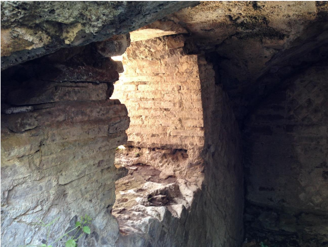
Abb. 64: Tivoli, Villa Hadriana, Winterpalast SO-Bereich; Blick in den Bedienungsgang („Ofen“) mit der Feuerungsöffnung zu dessen Beheizung aus dem trapezförmigen Nachbarraum.
