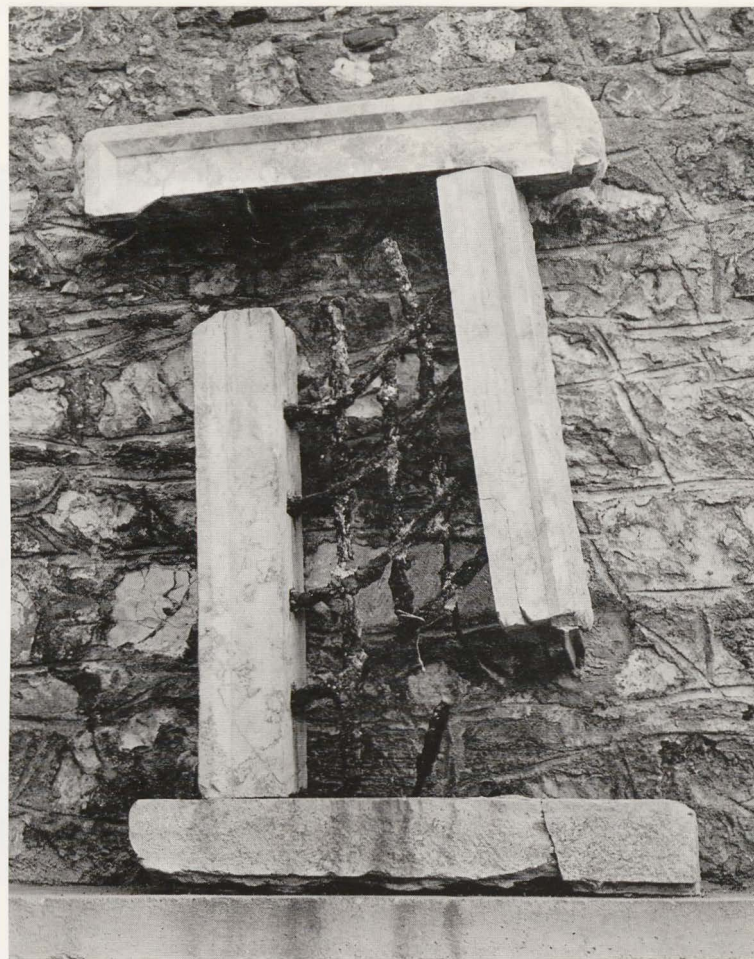
2. Vorderseite desselben Fensters. Das Eisengitter hatte sich beim Aufprall verzogen
