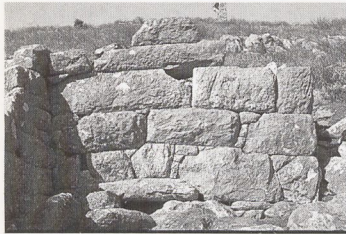
Dystos. Blick von Osten auf die Außenmauer von Raum G mit dem auf die Straße führenden Abfluß unter den Toilettensitzen (1977)
