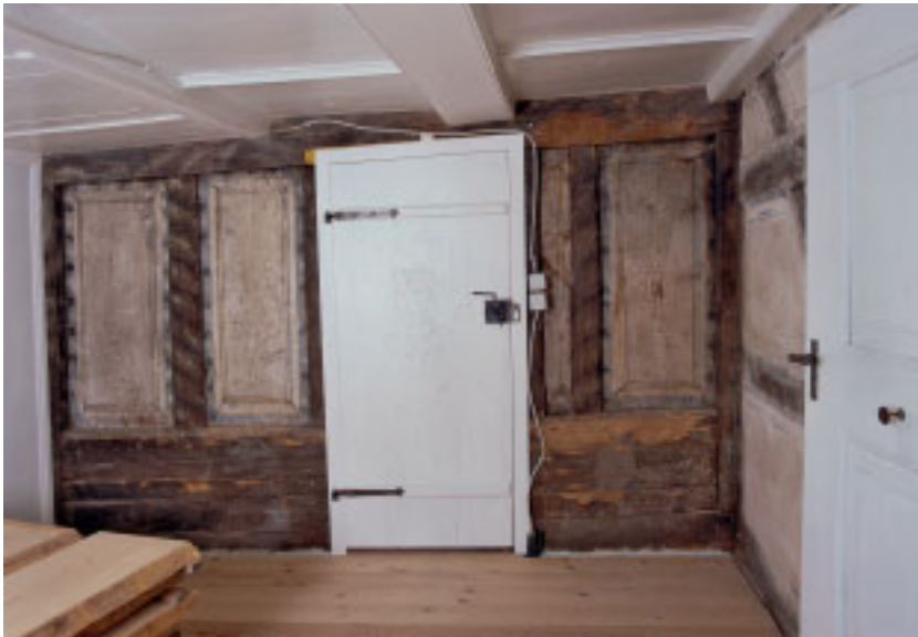
8 Die bemalten Fachwerkwände in der seitlichen Kammer des zweiten Obergeschosses gehören zur ältesten Ausstattung.
