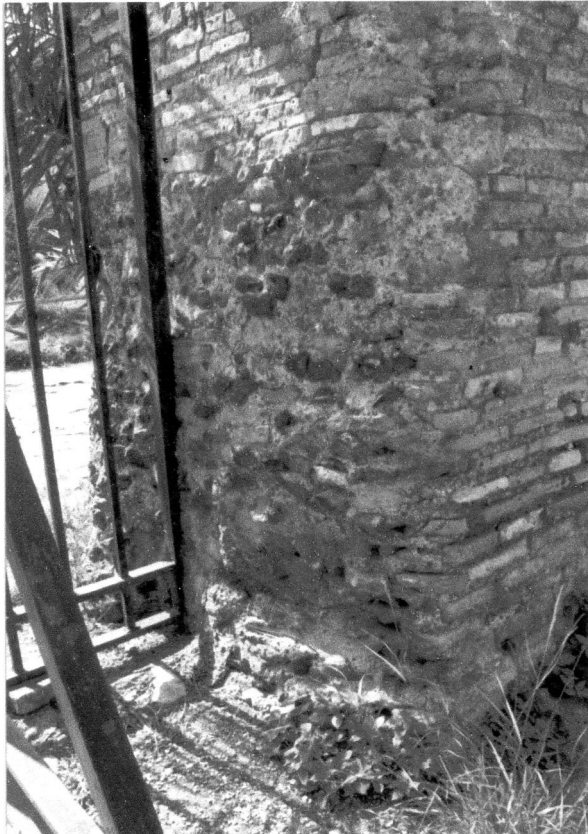
Abb. 23: Ostnarthex, abgearbeitete Fensterlaibung. Foto Schumacher, F 6/94 II, 8.
