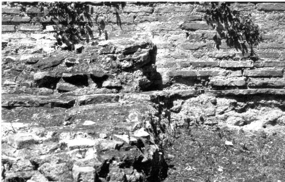
Abb. 45: Südseite, Terrasse vor dem Pfeiler zwischen mittlerem und östlichem Seitenjoch, Detail: Bipedalesschicht, die Terrassenbelag und Außenwandpfeiler verbindet Foto Schumacher
