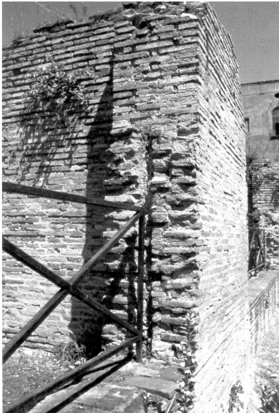
Abb. 49: Südwand, zweiter Pfeiler von Osten, Detail: abgebrochene Fensterlaibung. Foto Schumacher F 98 VI, 8.
