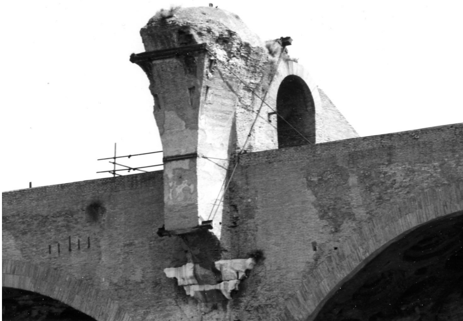
Abb. 66: Nordwestlicher Mittelschiffpfeiler, Detail: Kämpfergebälk und Rest des Kreuzgratgewölbeansatzes. Foto Schumacher F IV,25.
