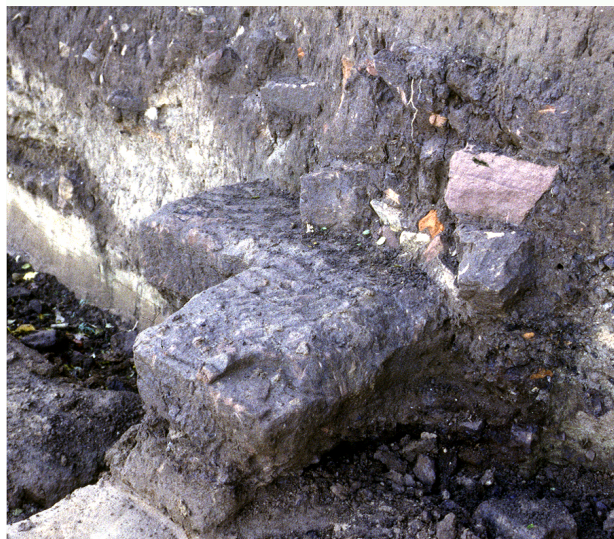
Abb. 117: Eisenberg, steinerne Subkonstruktionen für Holz- oder Lehmwände. Oben: Steinsetzung 1032 (H7/III) und Pfostenstein 2817 (H7/IV). Unten: Eckstein der Steinsetzung 1032 (H7/III).
