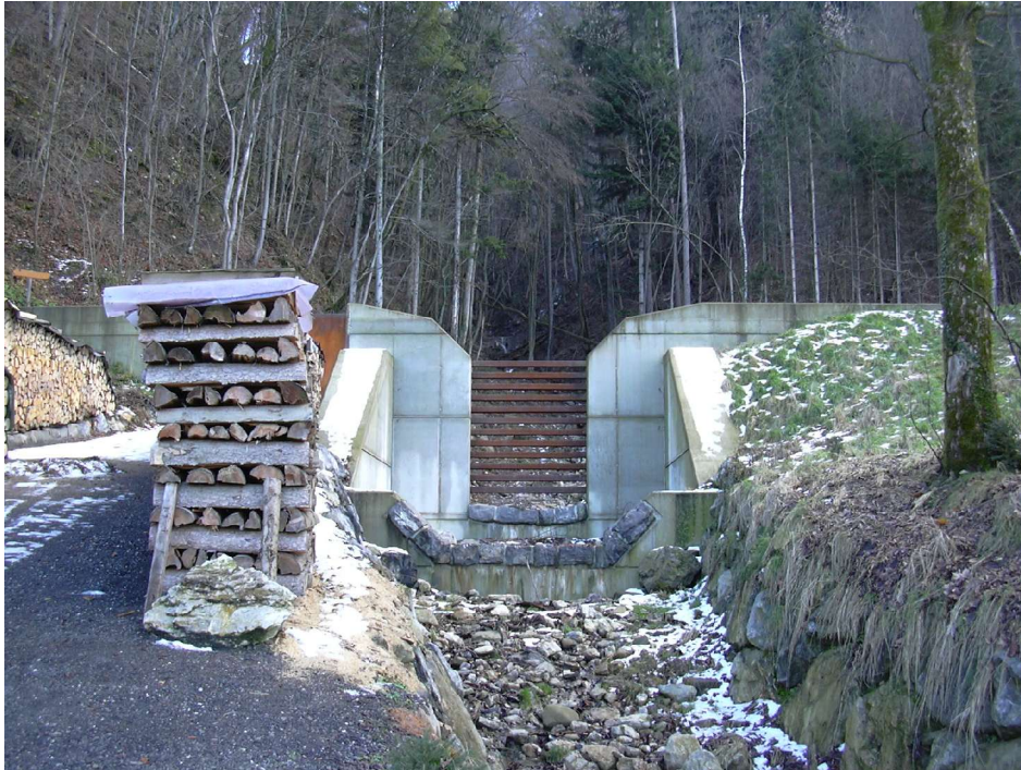
Abb. 3.7: Geschiebeablagerungsbecken mit Balkensperre am oberen Schwemmkegel des Pelzreutebaches (Höfle, 25.12.2004).
