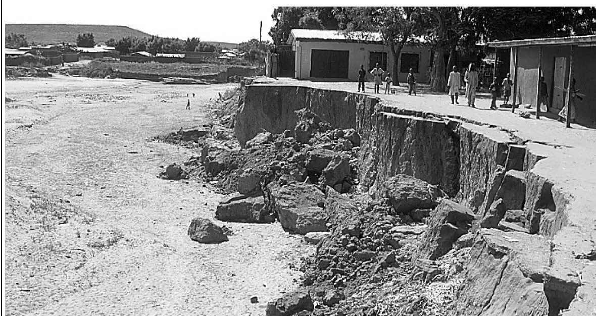
Abbildung 6-6: Die Bedrohung des Jekadafari-Gullies im Stadtteil Bogo BCGA
